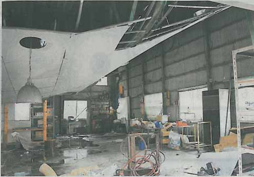
雪の重みで屋根が崩落した日向精工の工場
